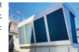
新冷媒を採用した機器を導入(草加工場)
