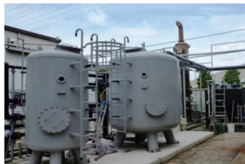
中水設備(草加工場)
