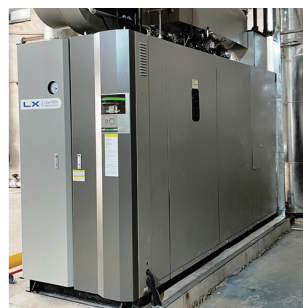
更新したボイラー(天津理研維他食品有限公司:中国)
